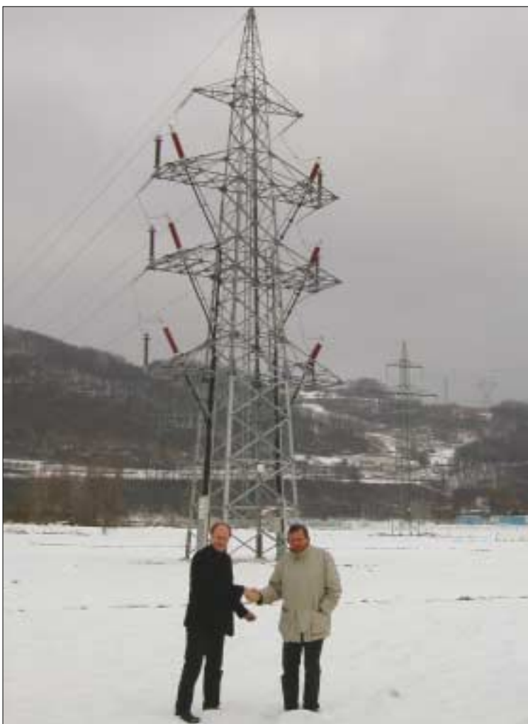
Znameniti steber, ki povezuje prostozračne vodnike in zemeljski kabel.
