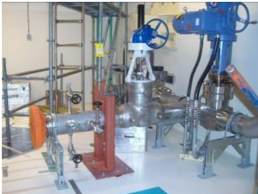
Slika 4: Del novo nameščenih cevi in ventilov pri sistemu odvajanja zaostale toplote
