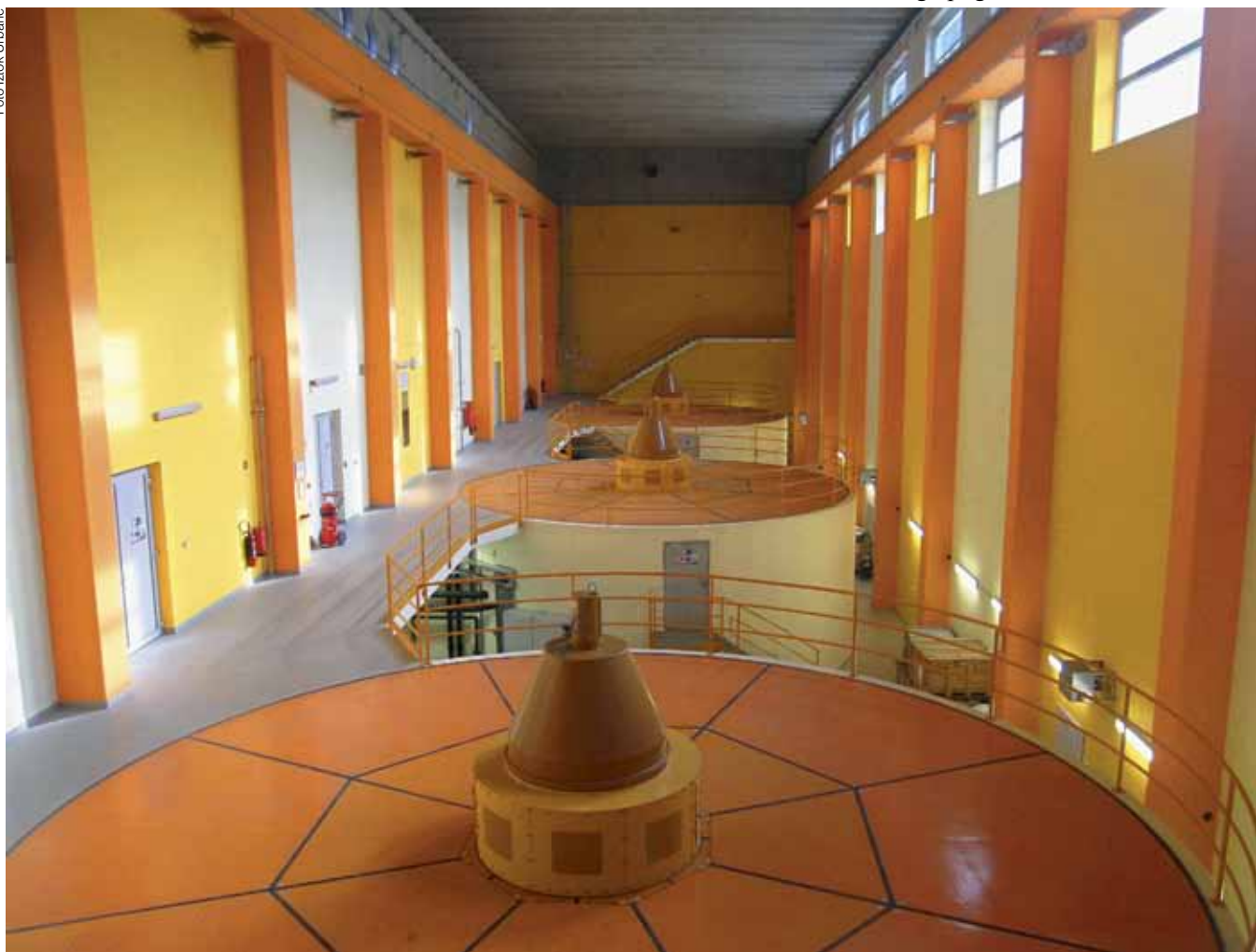
Montažna dvorana HE Krško
