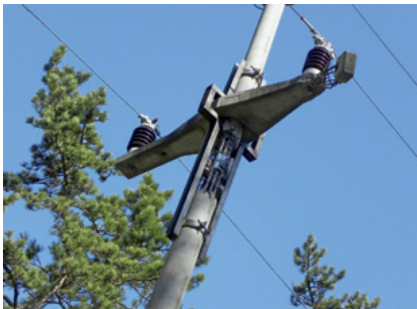
Začasno sanirani betonski drog, ki ga je zlomilo.
