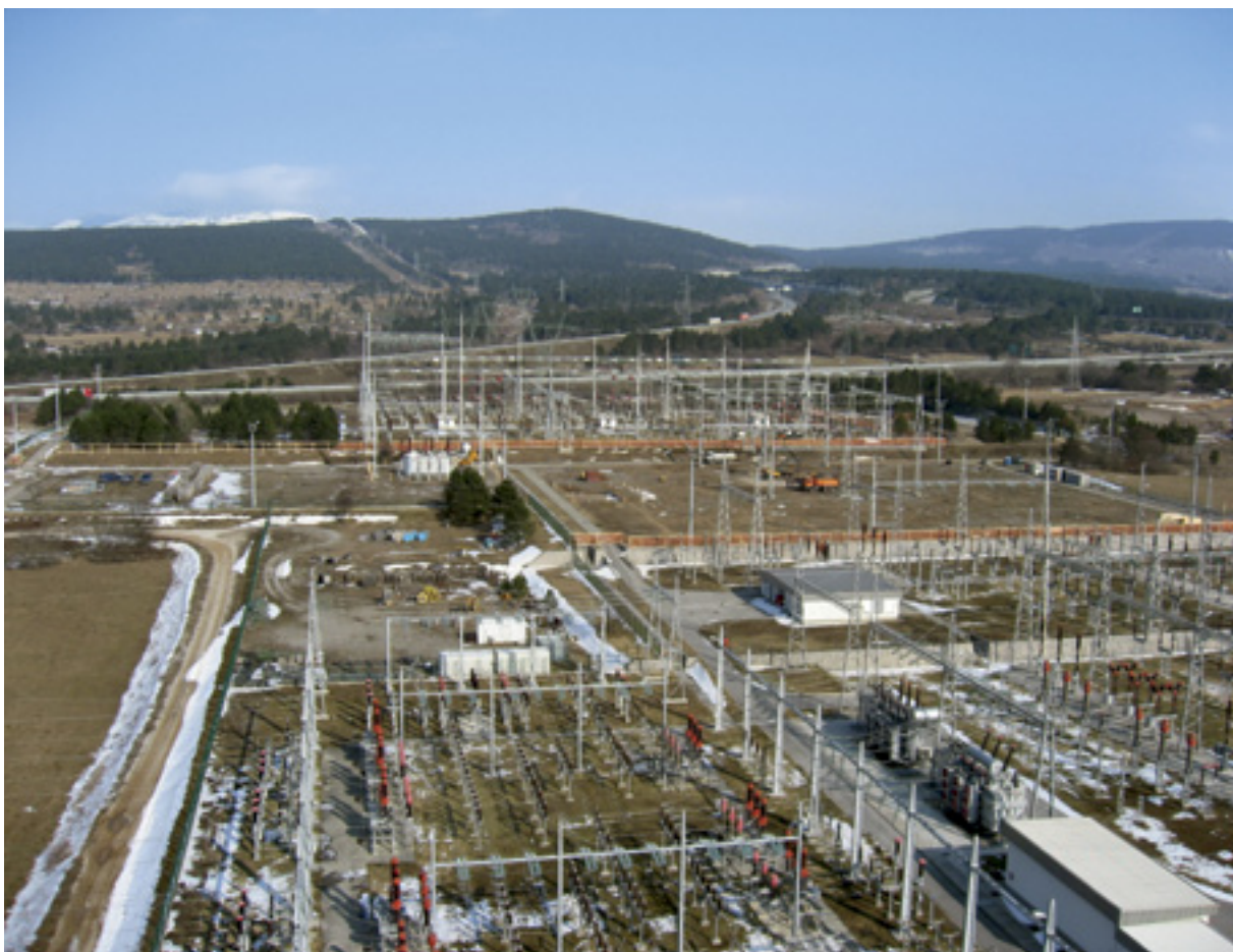
Pogled na RTP Divača s platojem prečnega transformatorja.
