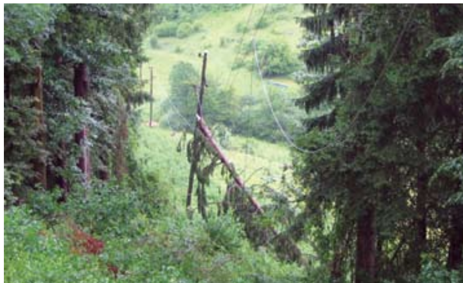
Poškodbe na 20kV daljnovodu Štrihovec-Pesnica.
