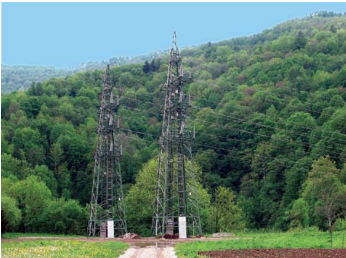
Dvosistemski daljnovod proti Novi Gorici.
