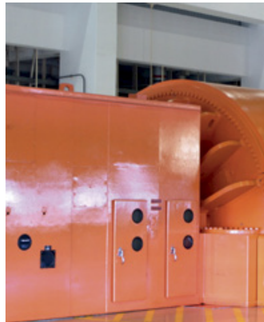
Električni generator z novim statorjem.
