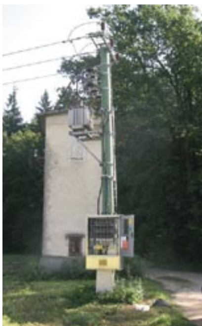
Sistem, nameščen v NNR transformatorske postaje
