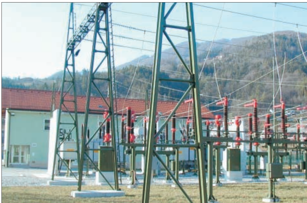
Sodobno 110 kV stikalnišče naj bi v prihodnje odjemalcem zagotovilo še zanesljivejšo in bolj kakovostno oskrbo z električno energijo.
