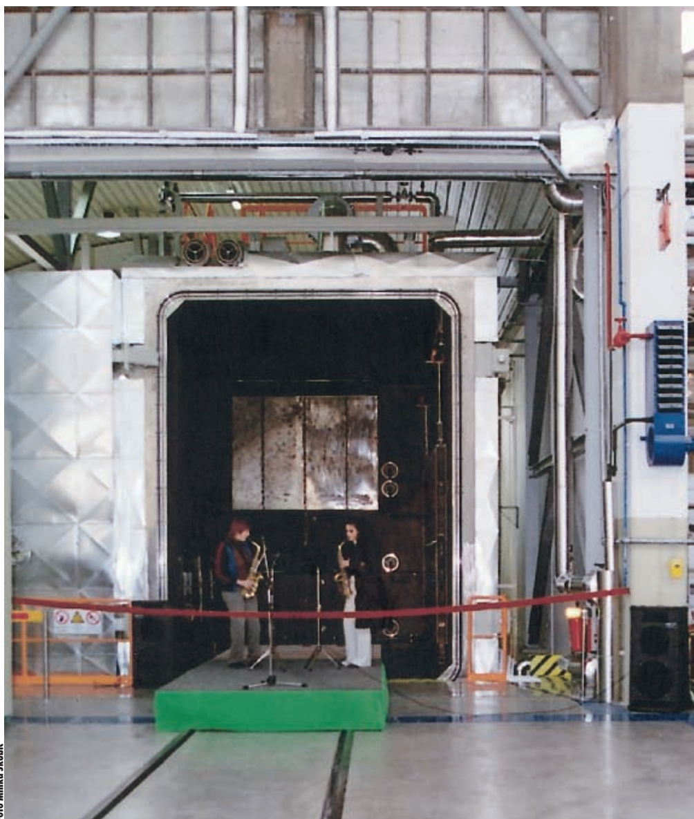
Vhod v novo peč za sušenje transformatorjev.
