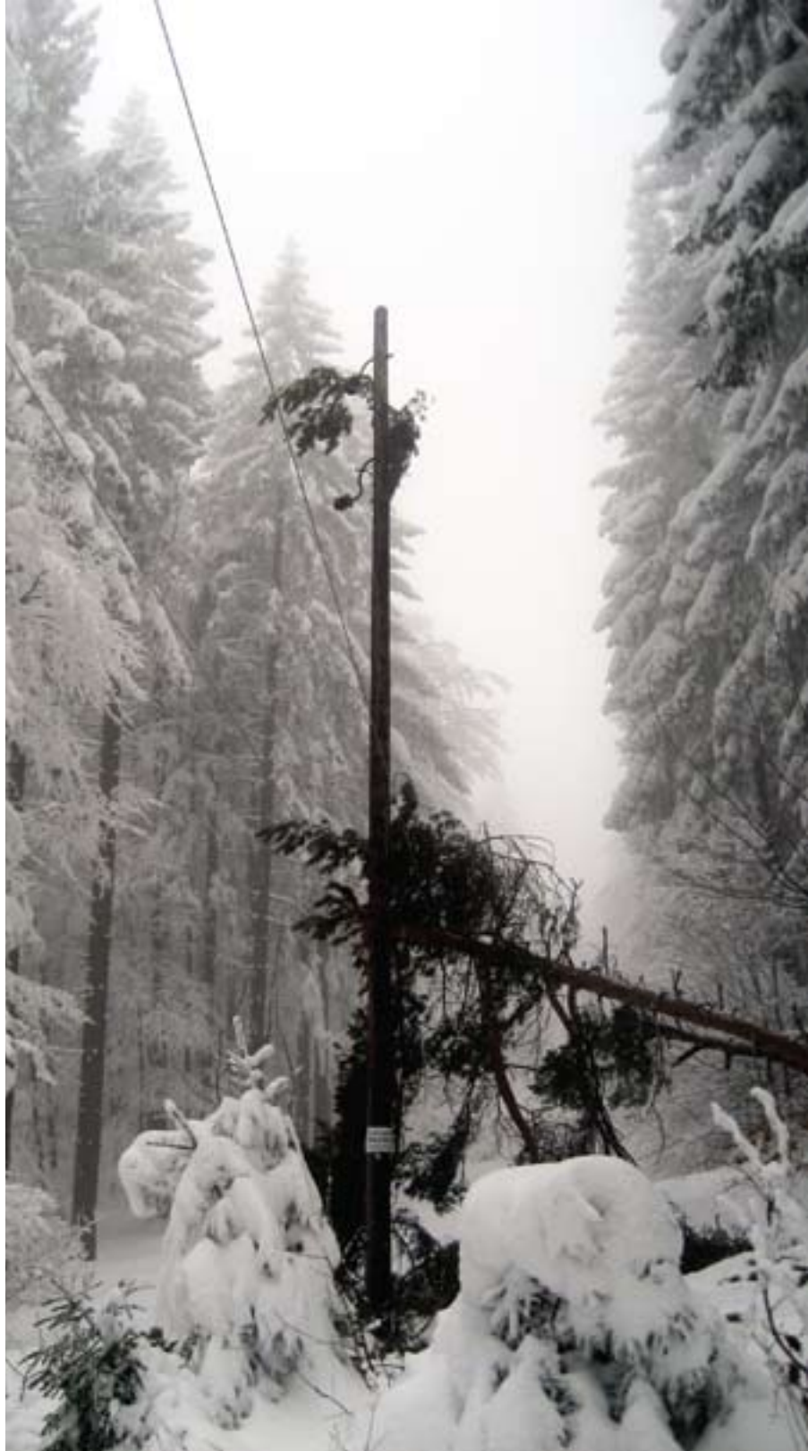
Poškodbe na daljnovodu Vzpenjača.
