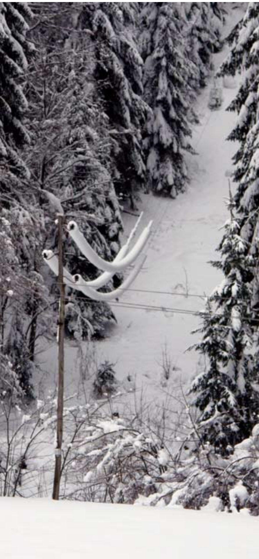
Foto arhiv Elektra Maribor
