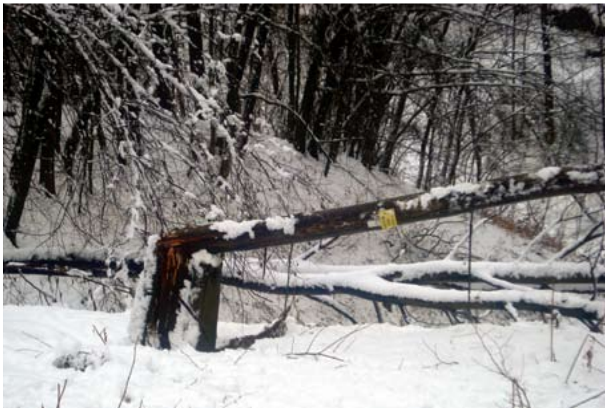
Porušeni daljnovod Šober.
