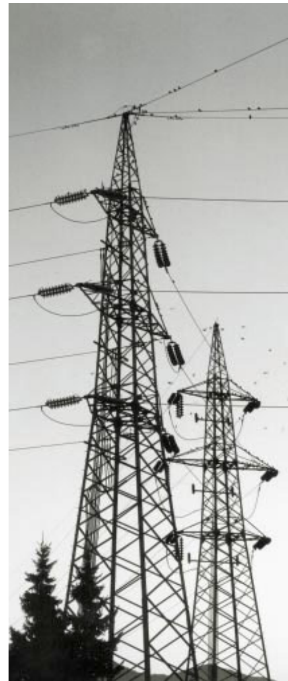
110 kV daljnovod RTP Primskovo - RTP Labore
