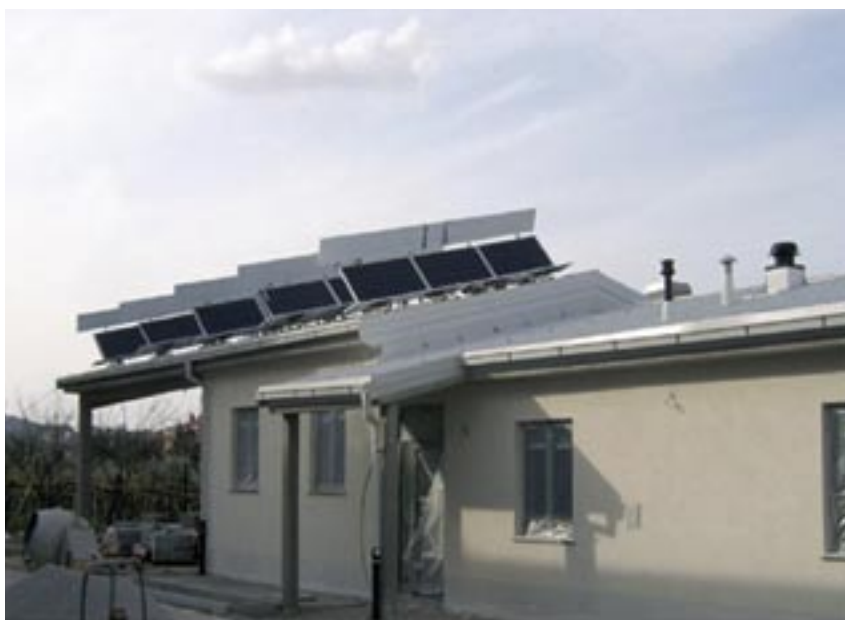
Sončna elektrarna v Izoli.
