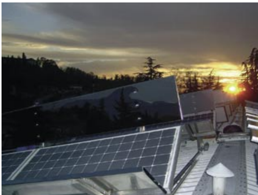
Sledilna sončna elektrarna v Novi Gorici.
