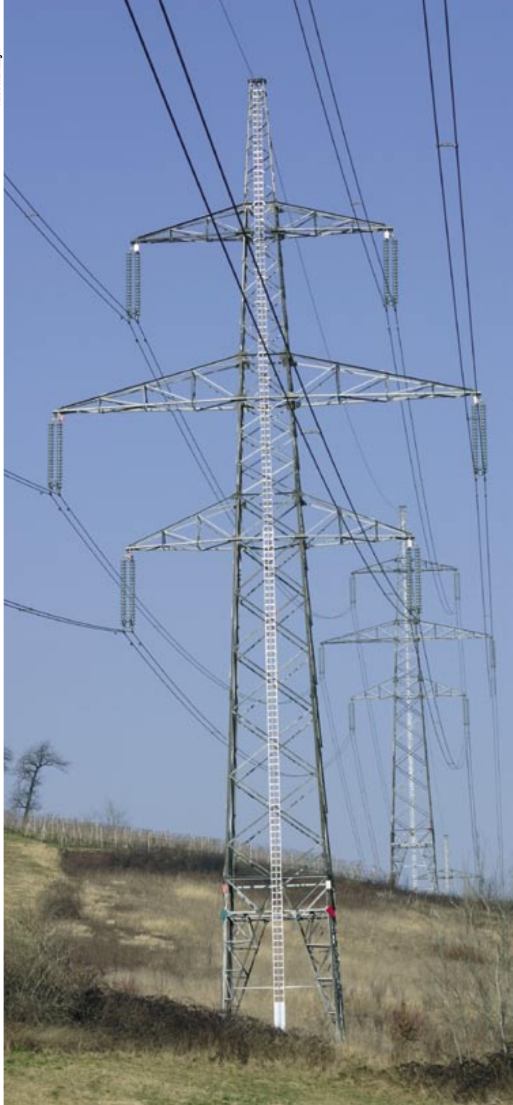
Vzpenjalni sistem na 400 kV daljnovodu Maribor–Kainachtal.
