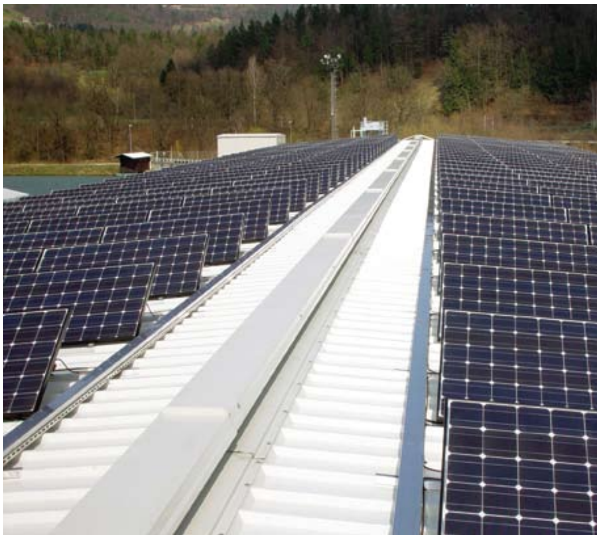
Fotovoltaična elektrarna na strehi HE Vrhovo
