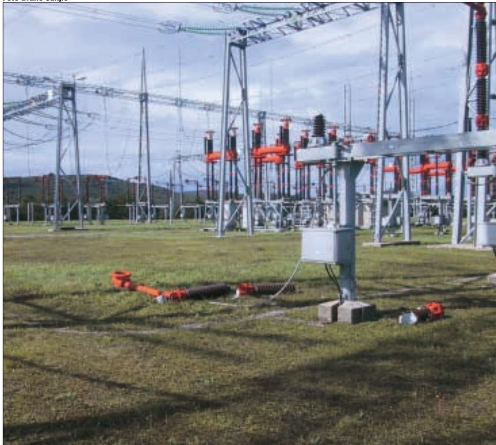
Zlom nosilnega izolatorja je dela pospešil.
