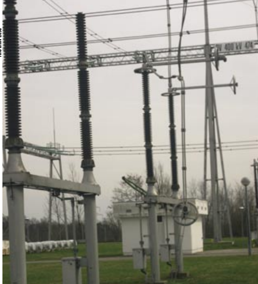
Poškodba ločilnika v RTP Maribor je že druga okvara enakega elementa v tem stikališču.
