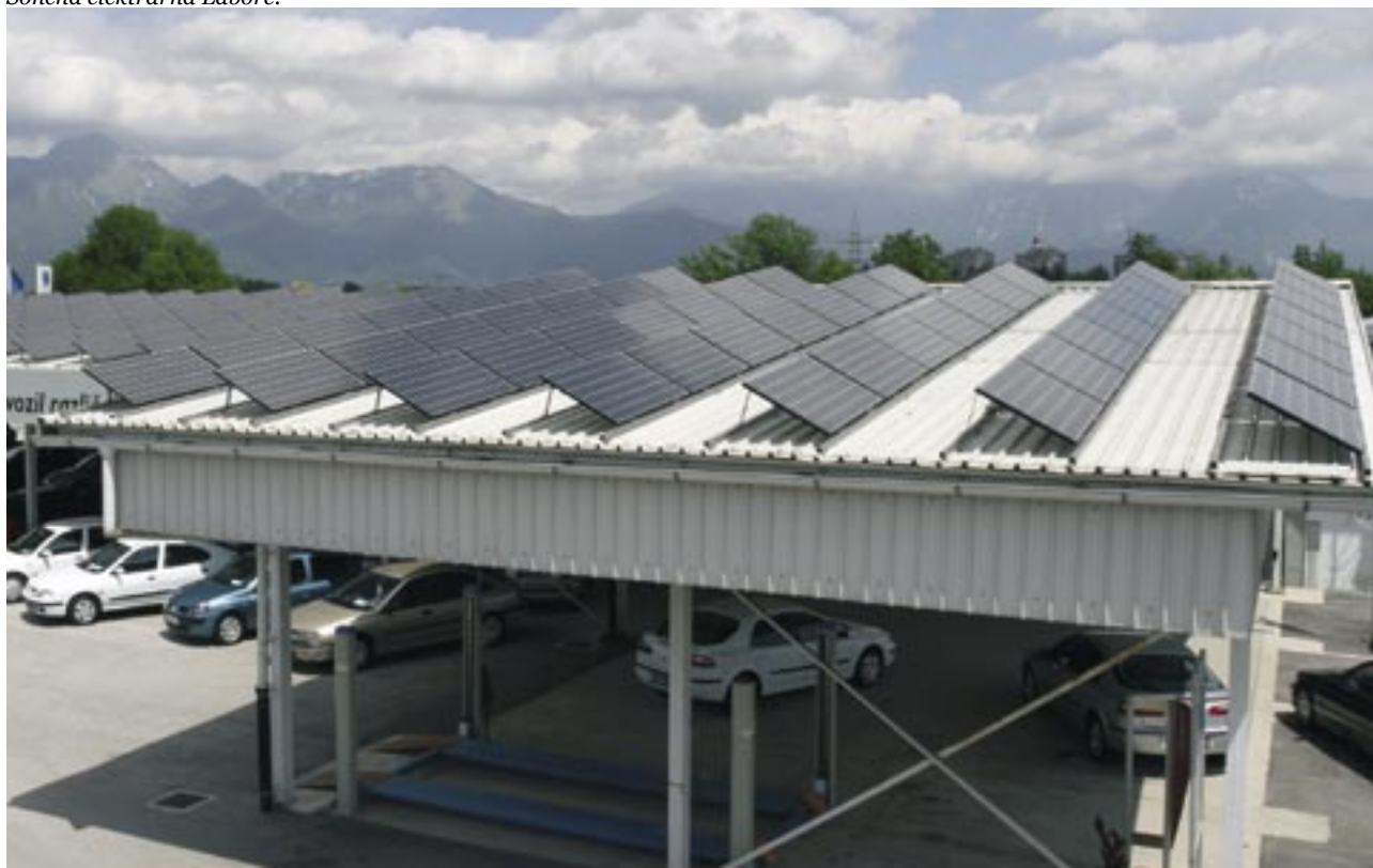
Sončna elektrarna Labore.
