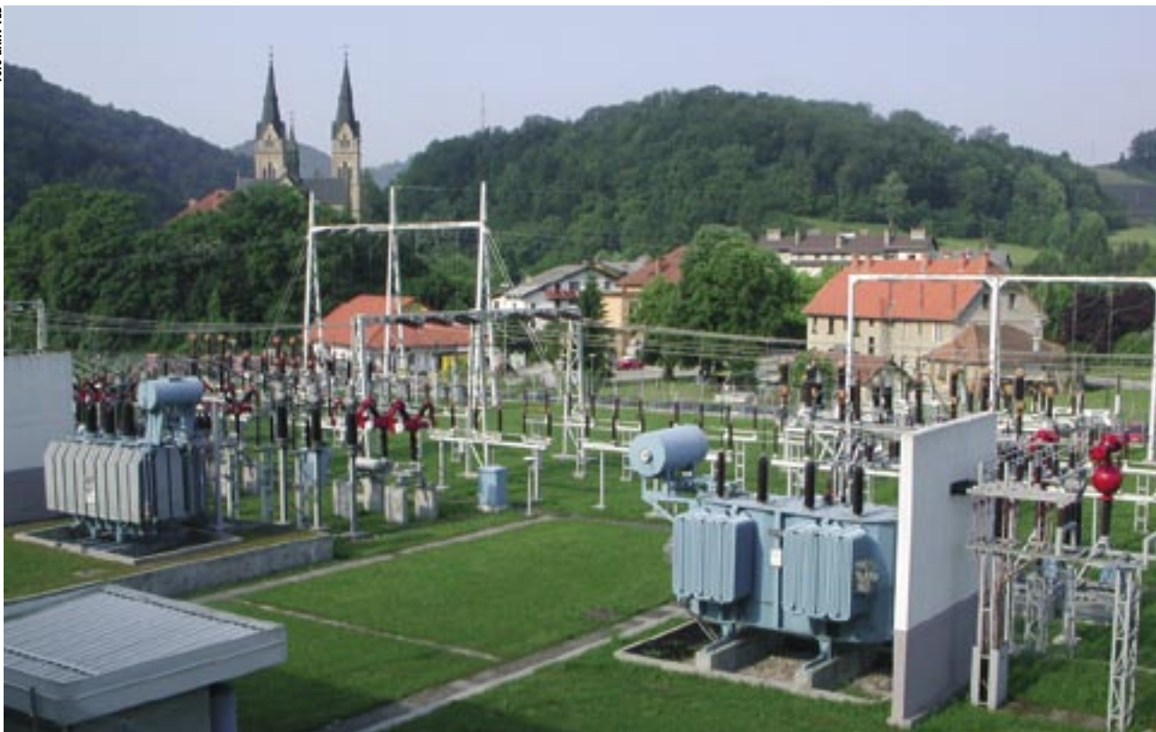
Obstoječe prostozračno stikališče 110/20kV v TEB.
