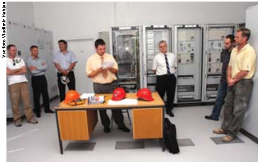
Predsednik komisije bere zapisnik strokovno tehničnega pregleda v komandnem prostoru nove komandne zgradbe.
