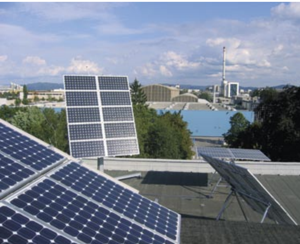
Kolektorji na strehi srednje šole tehniških strok Šiška kot del učnih programov.
