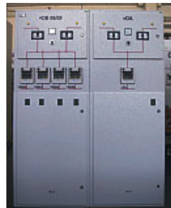
Razdelilna plošča v relejnih hišicah RTP
