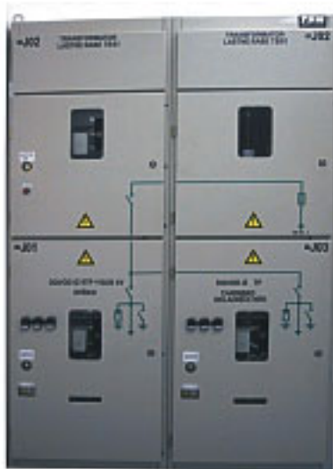
Srednjenapetostni stikalni blok 20kV
