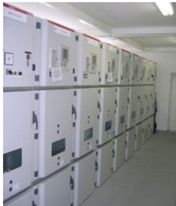
Novo stikališče 20 kV.
