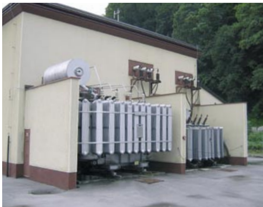
RTP 35/10 kV Laško mesto z dvema TR 8 in 10 MVA 35/10 kV.
