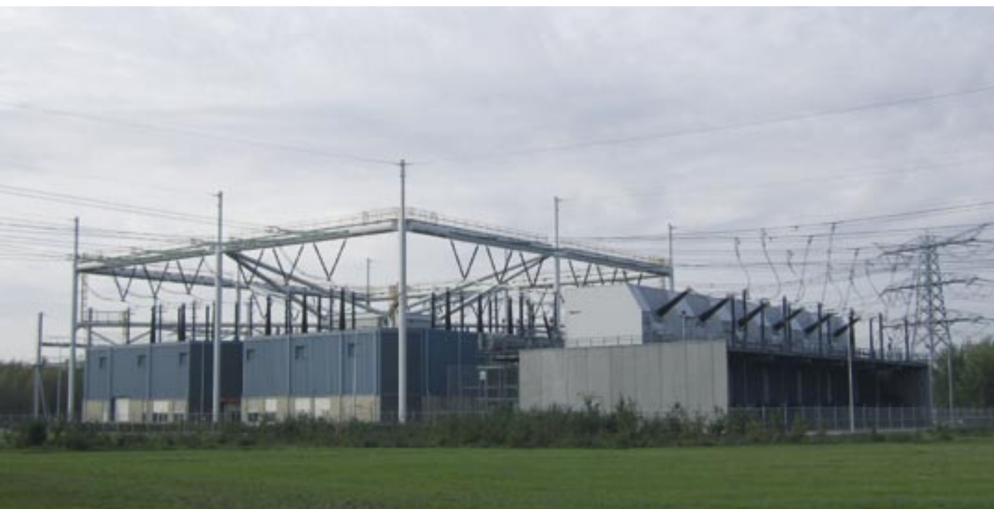
Transformatorska postaja Meeden s prečnimi transformatorji.
