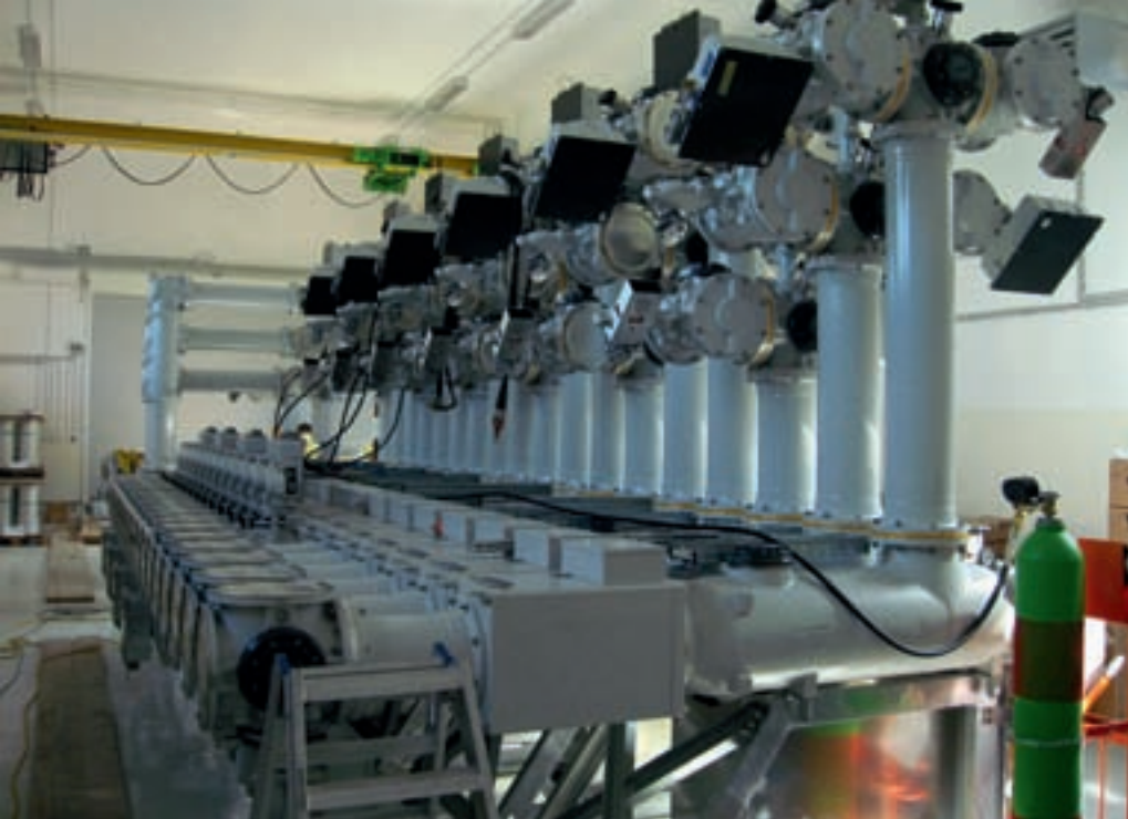
Pogled na novo stikališče GIS v RTP Moste.
