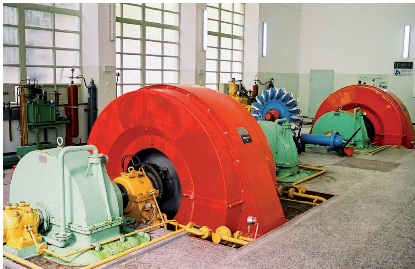
Notranjost hidroelektrarne Savica, zgrajene leta 1949
